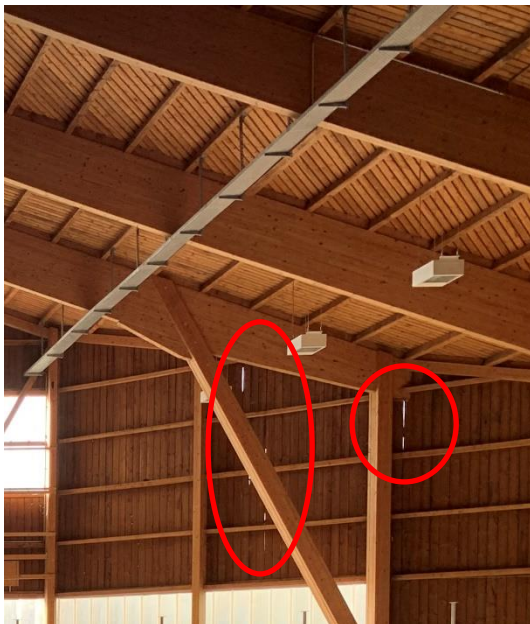
Abbildung 5: Ansicht auseinanderklaffende Vertäferung
